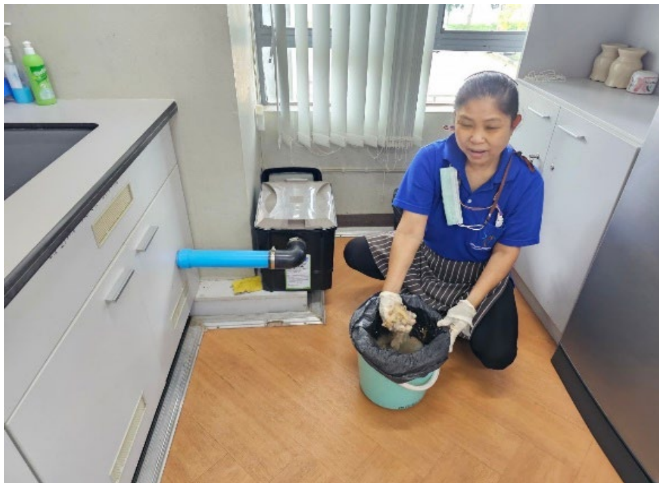
รูปที่ 2 คณะมีตะแกรงดักเศษอาหาร มีบ่อดักไขมัน หรือมีระบบบำบัดน้ำเสียเหมาะสมกับองค์ประกอบของน้ำเสีย
